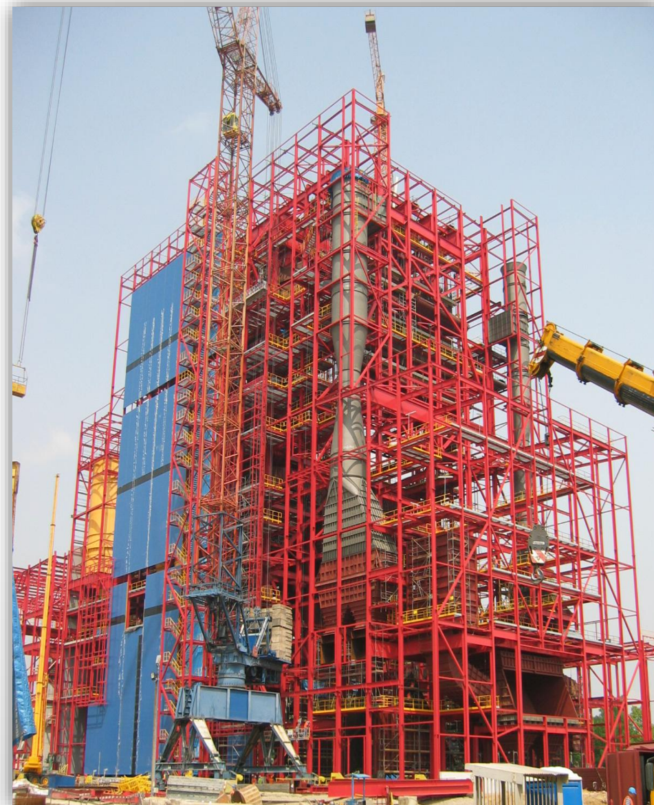
Elektrownia Łagisza kotłownia; 3 000 Mg
