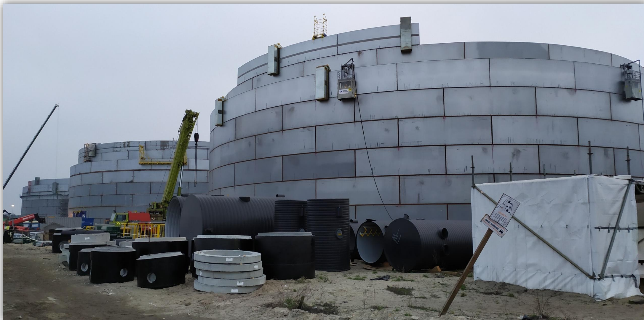
Zbiorniki V=100.000 \text{ m}^3 - Terminal Naftowy Gdańsk
