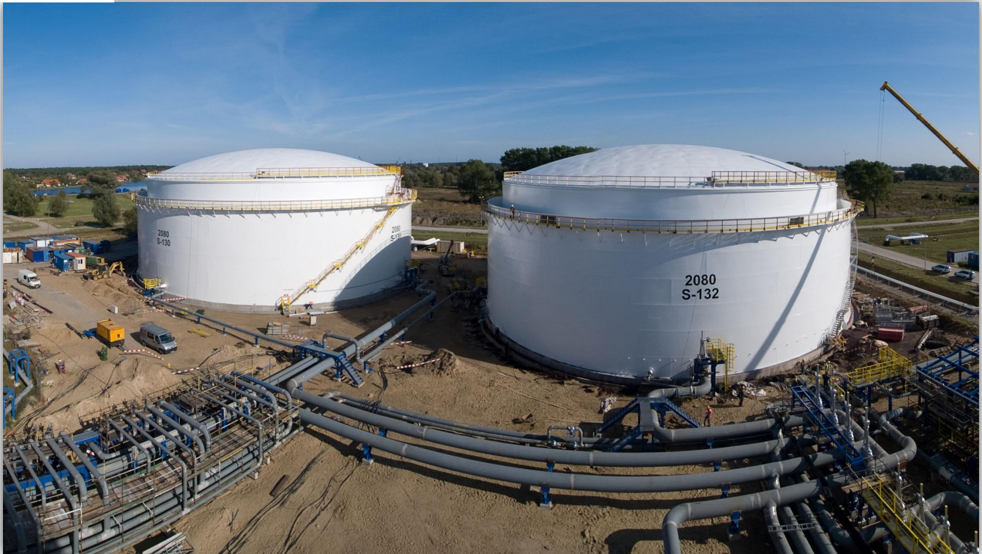
Zbiorniki paliwa 3 szt., V = 32\,000\text{ m}^3 , 3 360 Mg
